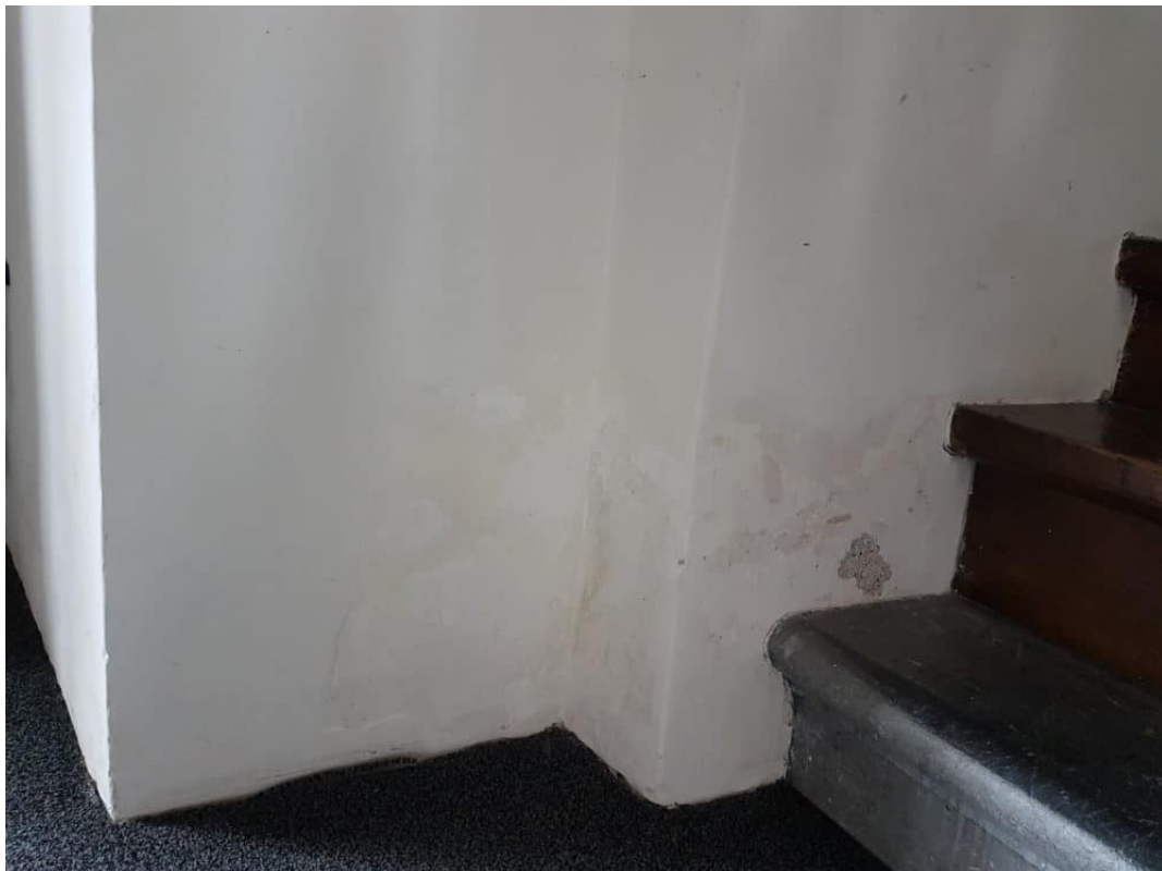
Starke Ausblühungen im Sockelbereich.
