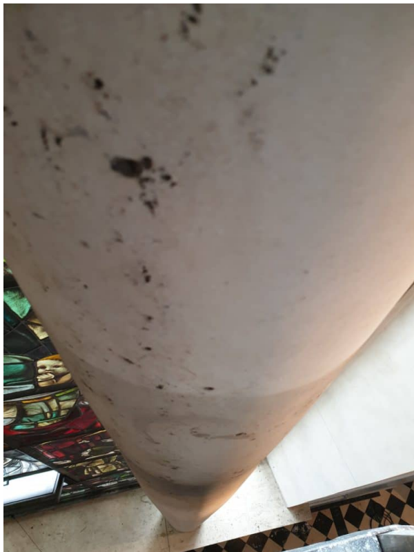
Trockenfreilegung der Säulen bei den Fenster. Oben gereinigt / unten verschmutzt.
