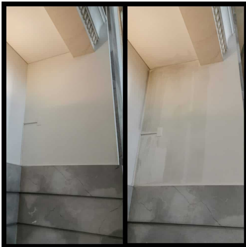
Links fertig / rechts verschmutzt Flecken und Schadstellen werden örtlich mit Mineral Farbe ausretuschiert.
