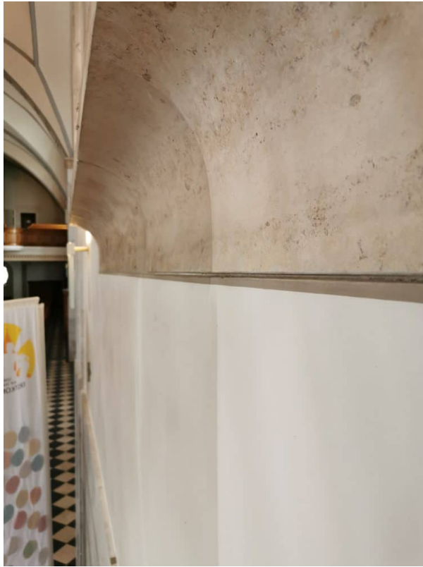
links verschmutzt / rechts gereinigt Unterhalb der Fenster im Schiff.
