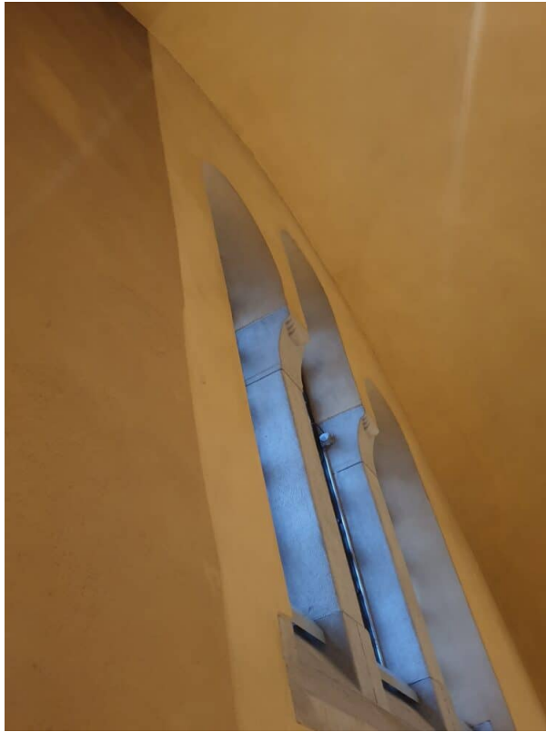
Ansicht der Verschmutzung: links verschmutzt / recht gereinigt
