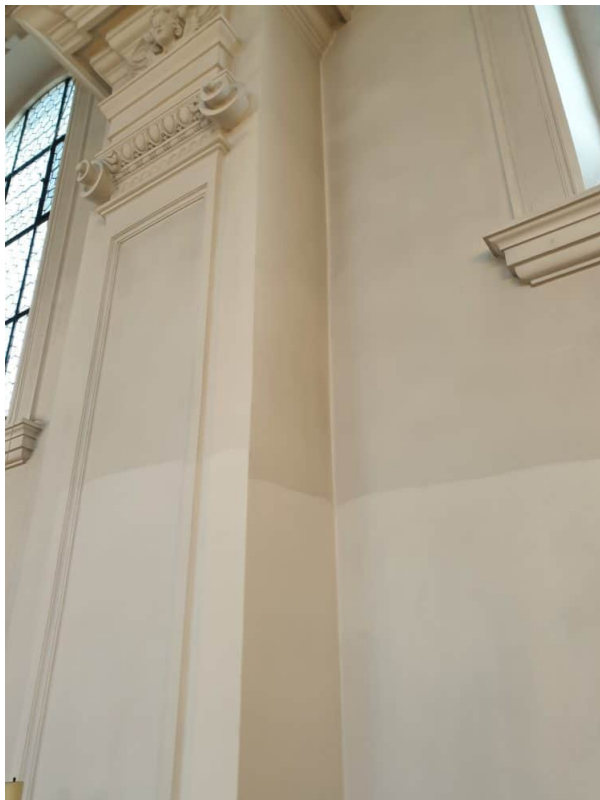
Trockenreinigung 2 Meter ab Boden. Unten gereinigt / Oben verschmutzt
