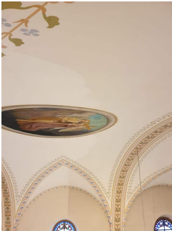
Ansicht Gewölbe im Schiff: Links gereinigt / rechts verschmutzt
