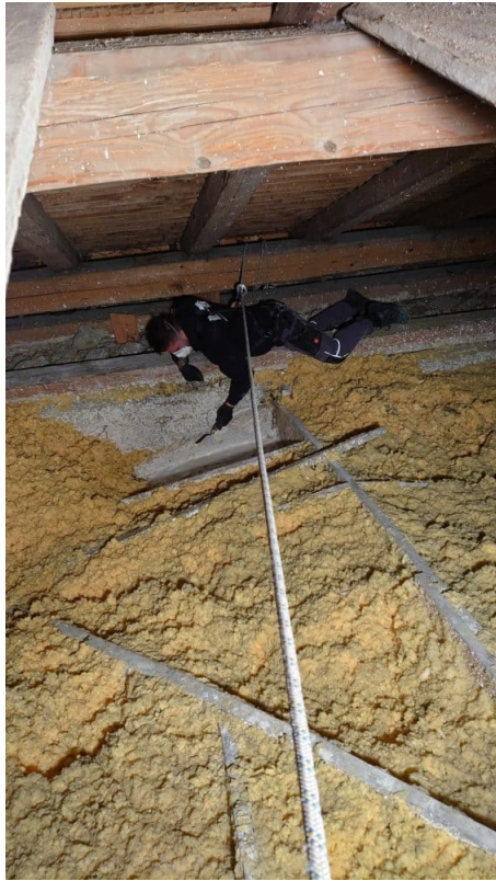
Wasserschaden im Dachstock des Gewölbes im hinteren Teil zur Orgel Empore. Faule Stellen werden abgetragen und anschließend mit einer Gips Mischung neu übergossen.
