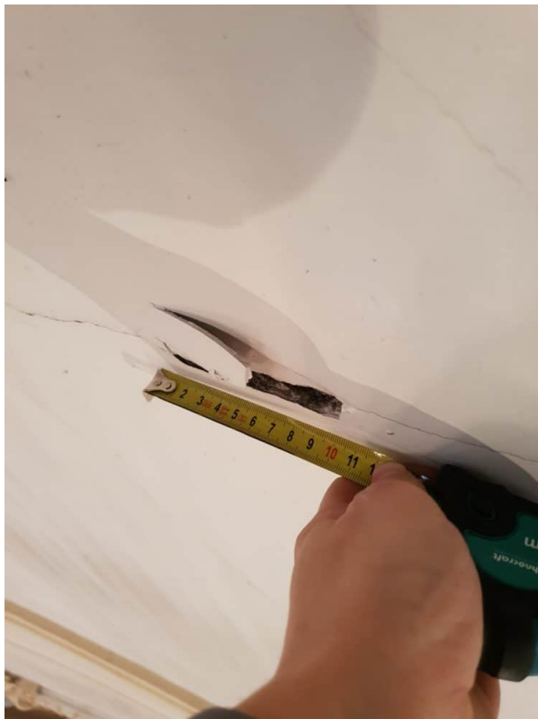
Ansicht Riss und Abplatzung ca. 10 cm lang. Die lose Stelle ca. 5 cm wurde abgestossen.
