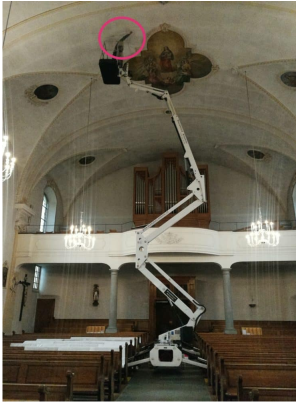
Untersuch Abplatzung Riss Im Gewölbe mit Spez. Lift in Position oberhalb des Kreuzganges.
