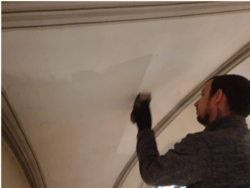
Trockenreinigung am Gewölbe im Chorhaus. links verschmutzt / rechts gereinigt.
