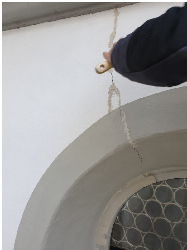
Risse Oberhalb der Fenster.
