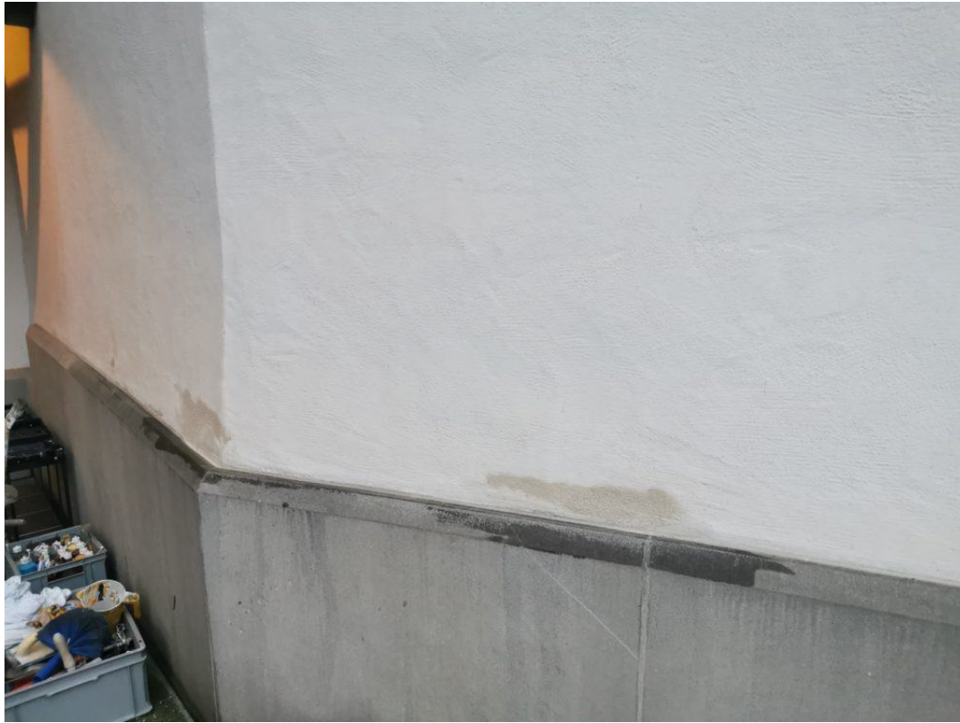
Zu geputzte stellen im Sockelbereich.
