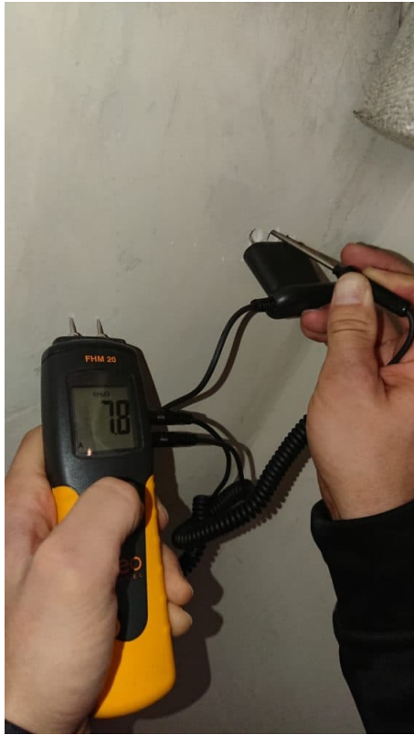
Die Feuchtigkeit der Wände sind gut. Raumtemperatur bei 16 Grad, Luftfeuchtigkeit 60% und Feuchtigkeit der Wände 7,8 H 2 O.
