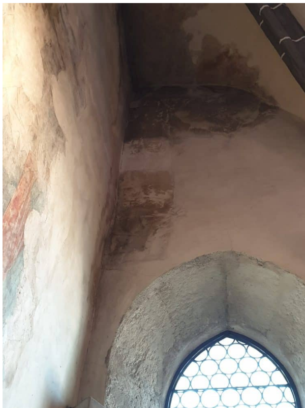
Wie mit der Denkmalpflege (Klaus Troger) und Restauratorin (Karoline Wirthner) besprochen, wird die Zinterschicht und die Faulstelle abgestossen und abgeschliffen. Anschliessend mit artgerechtem Material wieder angeglichen an bestehende Oberfläche und mit Kalkkasein örtlich ausretuschiert.
