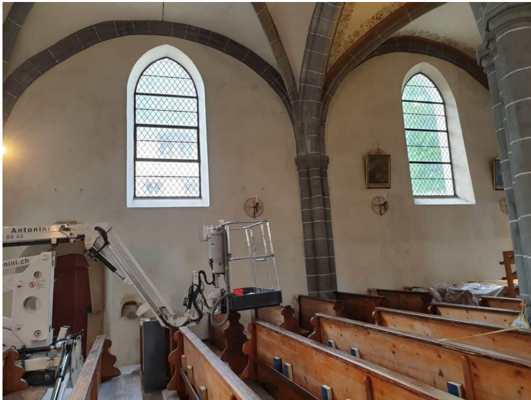
Wie mit der Denkmalpflege besprochen werden die Aussenwände des linken Seitenschiffes mit Kalkkasein 1-2 mal dünn lasiert.
