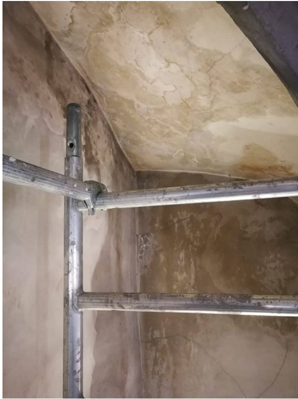
Wasserschaden im rechten Seitenschiff, vorne beim Eingang zum Turm rechts, oben an der Aussenwand und Gewölbe.
