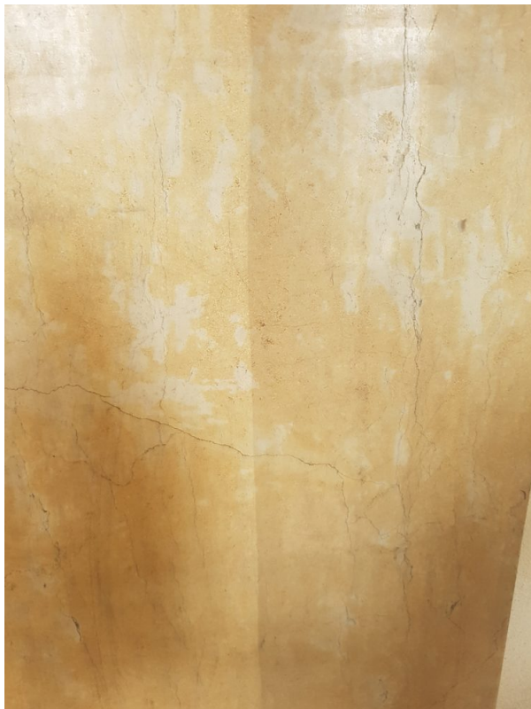
Ansicht Säulenschaft, auf der rechten Seite die Verschmutzung ersichtlich.
