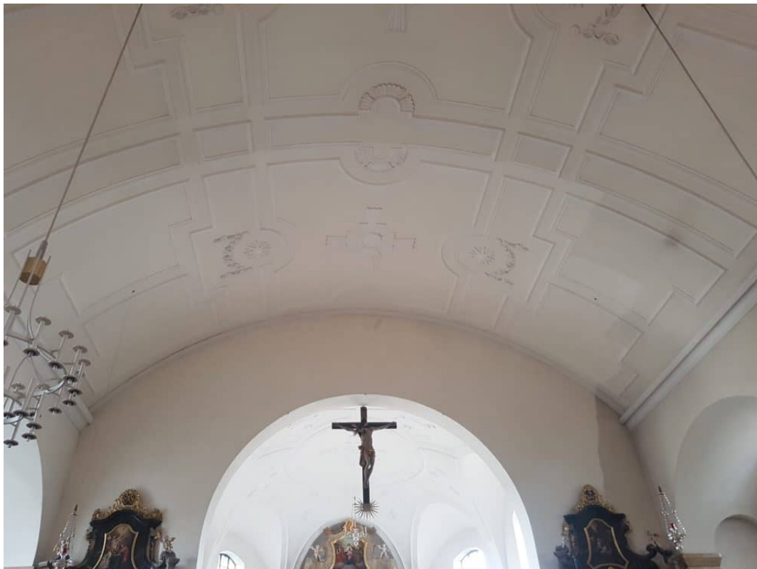
Ansicht vom Schiff/ Langhaus. Rechts ist die Verschmutzung ersichtlich.
