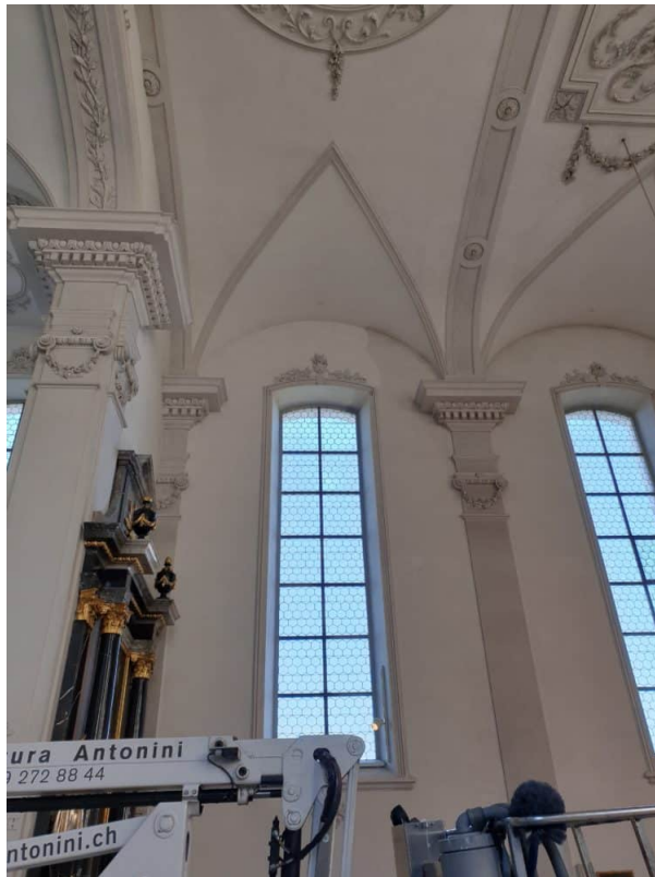
Trockenfreilegung im Schiff (unterschied an Aussenwand Rechts vom Fenster.)
